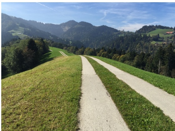
Betonspuren werden nicht ausgewaschen und sind dauerhaft. Bei Wanderwegen gelten sie als ungeeignete und ersatzpflichtige Eingriffe.
