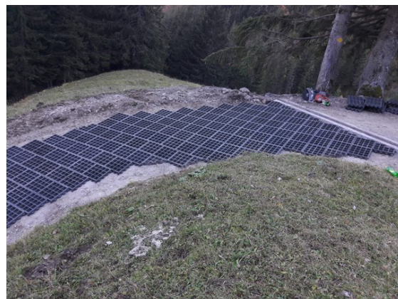
Bodengitter vor dem Verfüllen. Die Bodengitter müssen, insbesondere auf steilen Abschnitten, gut verankert sein.
