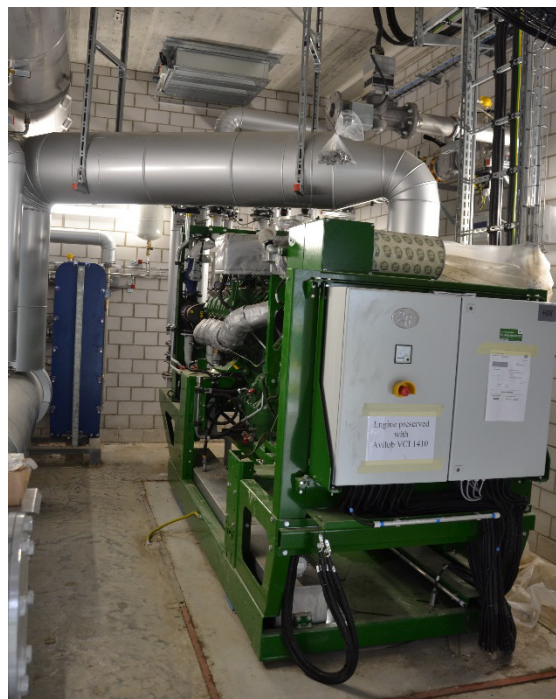
Der Motor verbrennt das Prozessgas und treibt damit den Stromgenerator an. Die Prozesswärme wird zur Schnitzeltrocknung und zur Gebäudeheizung verwendet. Damit Vibrationen nicht in Umgebungslärm umgewandelt wird steht der Motor auf Gummipfatten.
