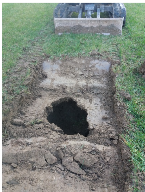
Erdloch über einer Drainage, entstanden durch langjährige Ausspülung
